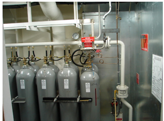
CO 2 -Löschanlage im Maschinenraum eines Schiffes.
